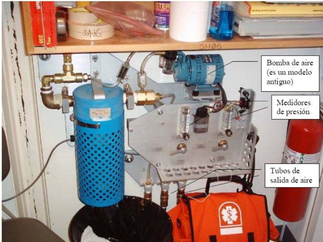
Foto 1: Detalle del sistema de aire limpio.
