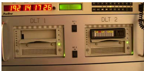
Foto 6: Drives de las cintas con el led "Operate Handle" encendido y las lengüetas levantadas.
