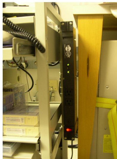
Foto 30: Regleta para la estación de trabajo y los periféricos.
