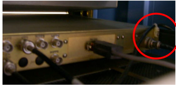
Foto 9: Localizar el cable coaxial negro de la antena de GPS.
