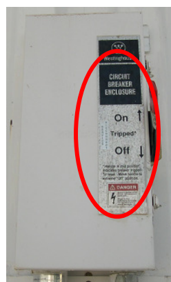
Foto 2: Palanca de toma general de corriente sin tapa.
