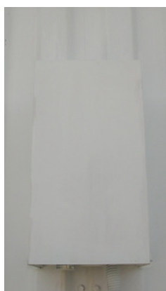
Foto 1: Palanca de toma general de corriente con tapa.
