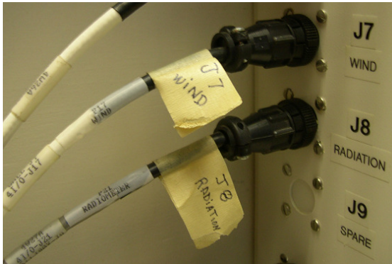
Foto 31: Cables J7 y J8.
