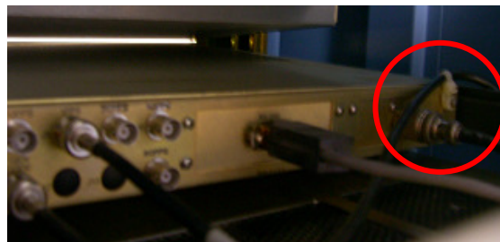
Foto 35: Localizar el cable coaxial negro de la antena de GPS.
