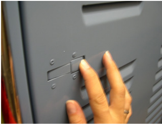
Foto 32: Abrir la puerta trasera del rack de la electrónica.
