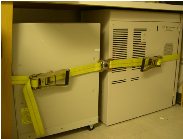
Foto 16: Interruptores del horno y del circuito de la UPS.
