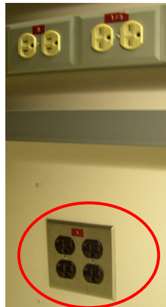
Foto 24: Conexiones de corriente AC no UPS.
