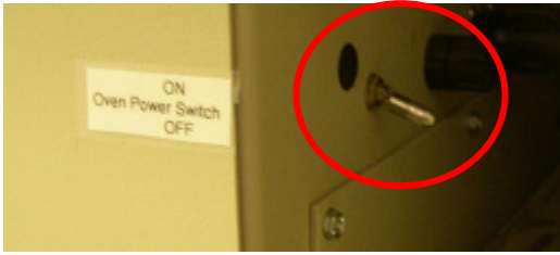
Foto 18: Interruptor del horno.
