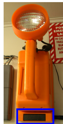
Foto 21: Linterna de emergencia.
