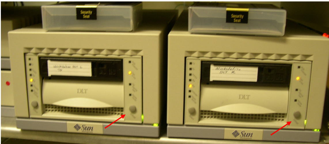
Foto 13: DLT drives de la estación de trabajo.
