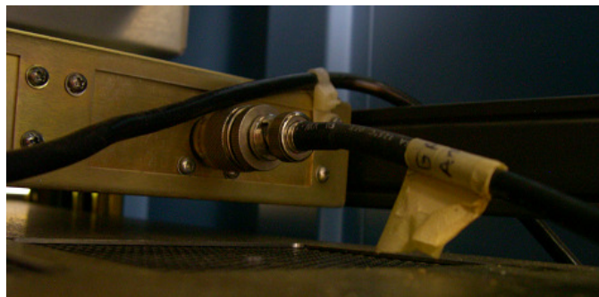
Foto 31: Cable coaxial negro de la antena de GPS.
