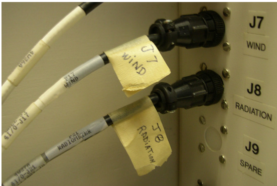
Foto 26: Cables J7 y J8.
