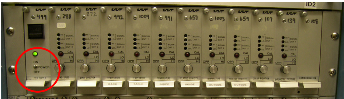
Foto 11: Fuente de alimentación de la estación meteorológica.
