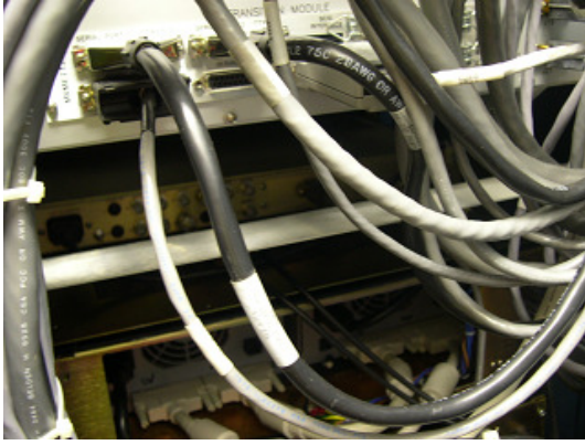
Foto 29: Localizar la parte posterior de la TRUE TIME GPS, detrás de los cables.
