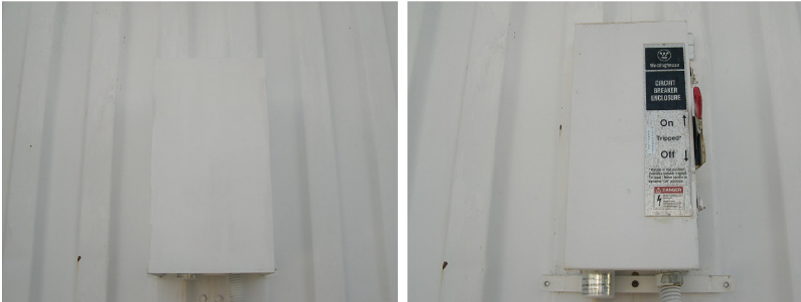
Fotos 4 y 5: Palanca de toma general de corriente del contenedor con tapa y sin ella, respectivamente. (Utility Main Power Circuit Breaker.)
