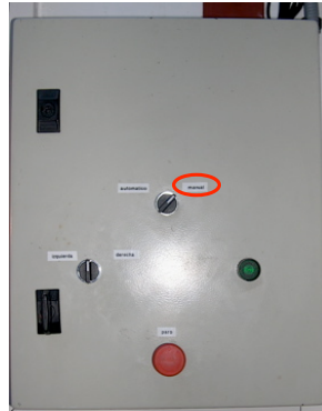
Figura 2: Electrónica de control del azimut de la cúpula.
