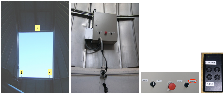
Figura 3: Izda.-Dcha.: Ventana abriéndose, donde 1 y 2 son los anclajes a la barra en 3 para abrir la compuerta; la cadena cuelga de 2. Caja de la electrónica para controlar ventana-compuerta. Imagen detallada de los botones anteriores. Mando de control de apertura
